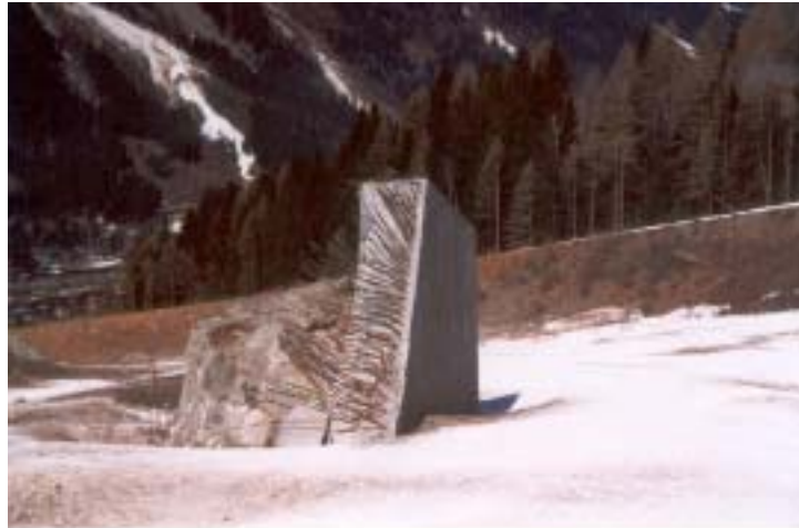
Dent déflectrice endommagée à Taconnaz – 02/1999
