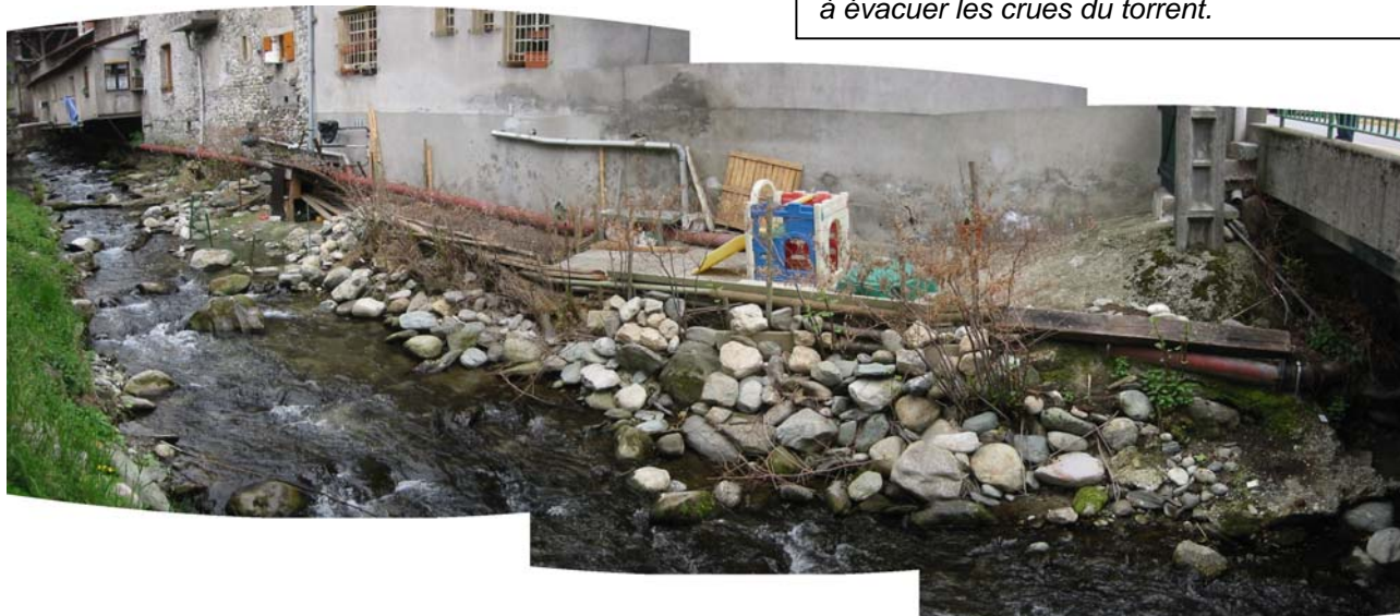
photo 2 : torrent des Adrets, communes de Froges (RD) et de Villard-Bonnot (RG). Utilisation anarchique du lit du torrent.
