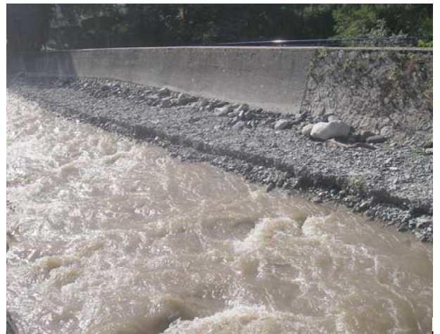
photo 11 : Domeynon, au droit du franchissement SNCF, dépôt en RG. Blocs pluridécimétriques posés sur un lit de galets ; tous ces sédiments ont été déposés pendant la crue.
