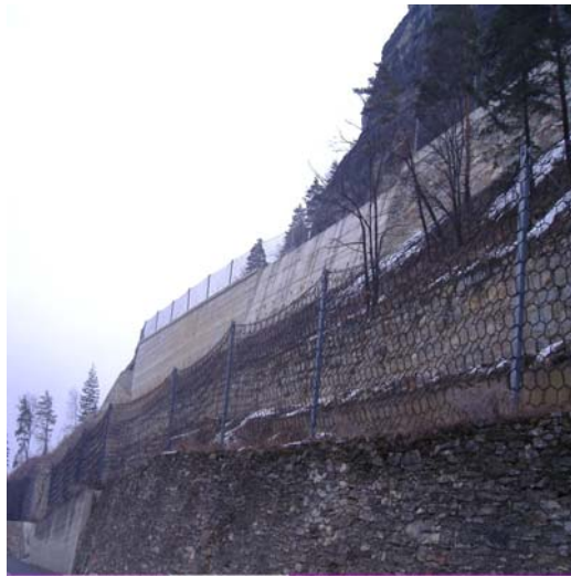
Photo 5.1.6. Vue d'ensemble du merlon en béton armé. A noter en aval du merlon la présence d'un écran déformable en anneaux pour protéger la RR 47 de Cogne.
