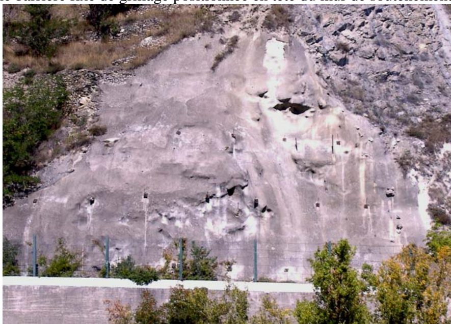
Photo5.10. 2 – Talus rocheux stabilisé à l'aide d'une couche de béton projetée sur un treillis d'armature ancré au talus. On observe, au premier plan de la photo, la barrière fixe de grillage. Cliquez pour agrandir
