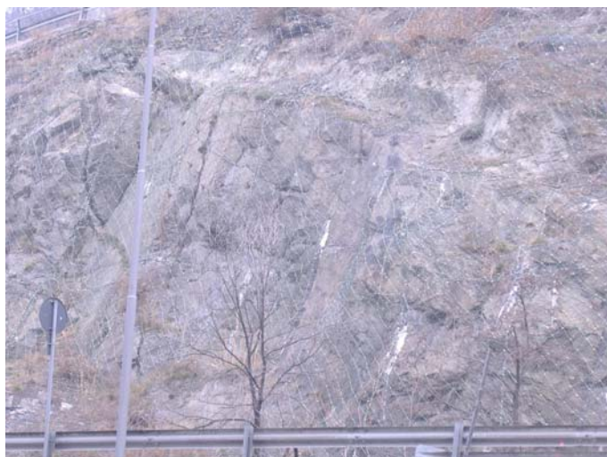
Photo 5.11.3. Combinaison de mesures de protection en amont de la route communale au lieu dit Rue de Rome, commune de Aoste.
