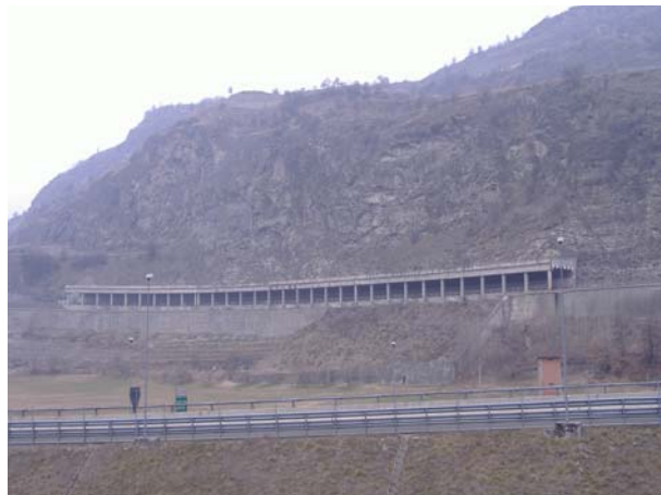
Photo 5.5.4. Galerie de section rectangulaire sur la RN 26 (Km. 108+350), communes de Sarre – Saint-Pierre, vallée d'Aoste Cliquer pour agrandir
