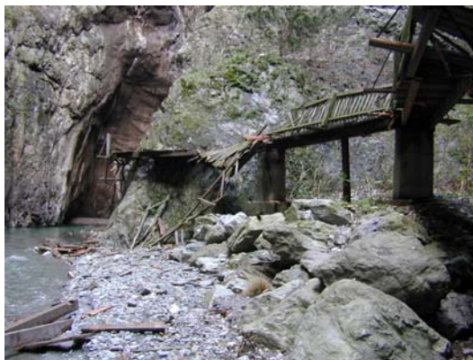
Photo 5.7.1: Dommages aux passerelles des gorges du Trient après les purges de 2002.
