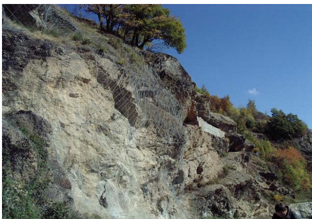
Photo 5.8.2 – Combinaison de mesures de protection le long de la route communale Avise-Thomasset. On y distingue des filets et grillages plaqués et un contrefort en maçonnerie.
