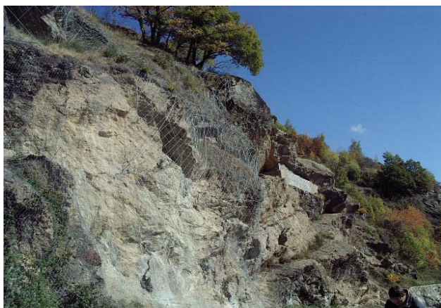
Photo 5.8.2 – Combinaison de mesures de protection le long de la route communale Avise-Thomasset. On y distingue des filets et grillages plaqués et un contrefort en maçonnerie.
