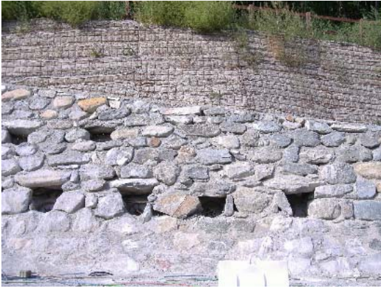
Photo 5.2: vue d'ensemble du mur de soutènement et des ancrages actifs (dans les trous).
