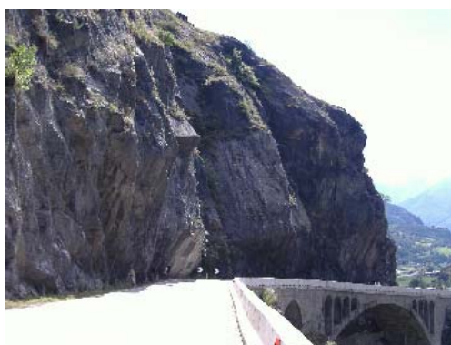
Photo 5. 1: Vue d'ensemble de la paroi avec les ancrages passifs (au centre) et les grillages plaqués.
