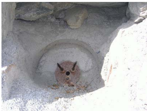
Foto5.3: Dettaglio del tirante con i tre trefoli e la piastra di ripartizion
