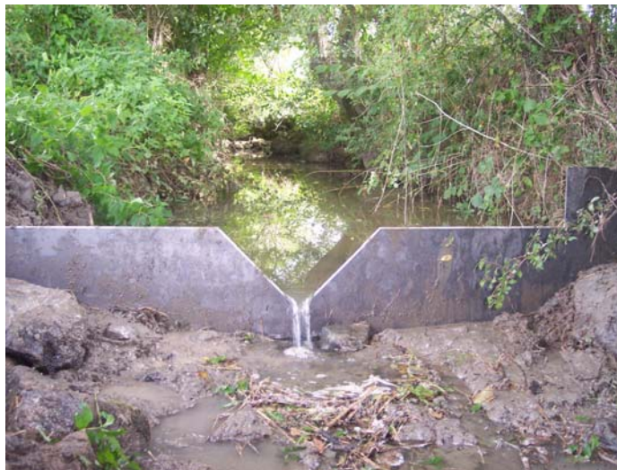
Figure 2.1. 6 : Seuil de mesures des débits sur le Crinzoux
