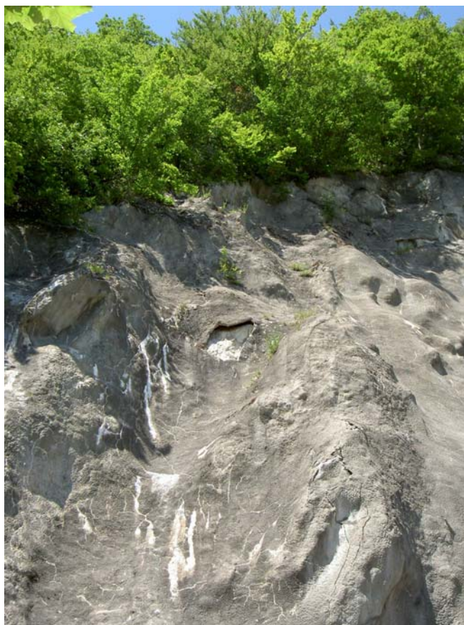
Photo 5.10.3: Talus rocheux calcaire stabilisé à l'aide de gunite sur la route Vouvry – Chavalon (commune de Vouvry). On observe le décollement de plaque de béton et l'absence de treillis d'armature. Cliquez pour agrandir
