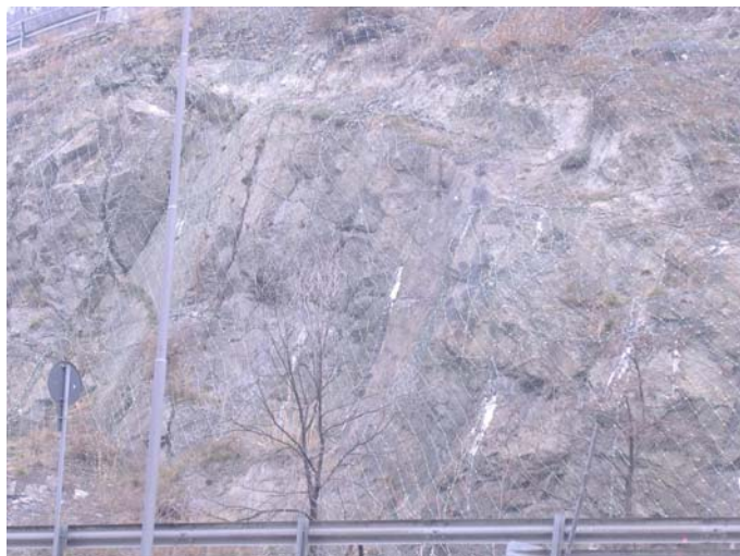
Photo 5.11.3. Combinaison de mesures de protection en amont de la route communale au lieu dit Rue de Rome, commune de Aoste.
