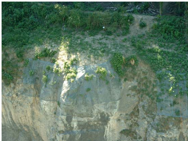
Photo 5.11.1: Filets PVC plaqués sur la bordure sommitale d'une paroi à la sortie nord de la ville de Saint Maurice
