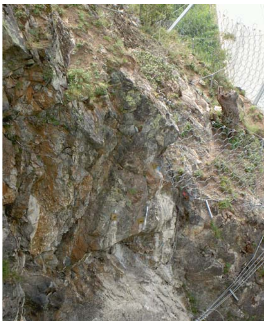
Photo 5.11.2: Combinaison de mesures de protection au dessus de la galerie de la Monnaie au lieu-dit "Les Trappistes" : filets pare-pierres de moyenne énergie, ancrages passifs et câblages.
