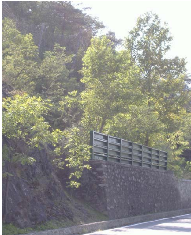
Photo 5.2a.1 – Ecran rigide en traverses métalliques. A noter l'écran déformable de filets à anneaux ROCCO® situé à l'arrière.
