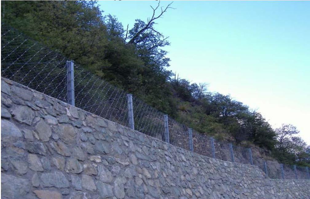
Photo 5.2b.2: Vue d'ensemble du mur de soutènement et de la barrière fixe de grillage et filet.
